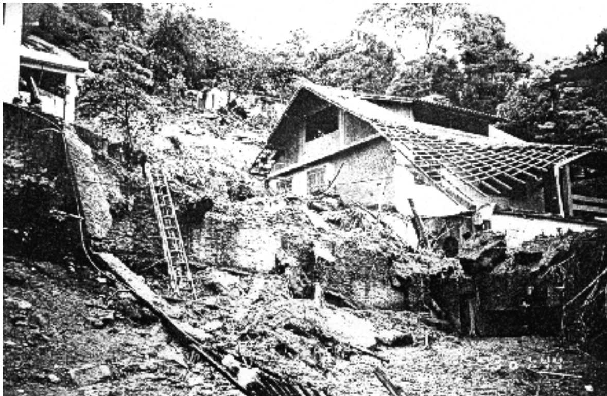
Figura 7 – Deslizamento numa encosta próximo ao local do Condomínio Popular
