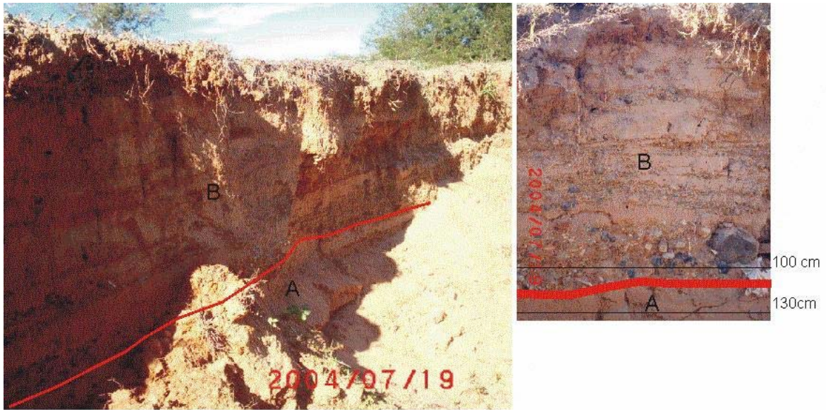
A: material resultante do processo de terraplanagem das áreas a montante. B: material com fragmentos de tijolos, telhas, plásticos, brita, oriundo dos restos de construção das residências.
