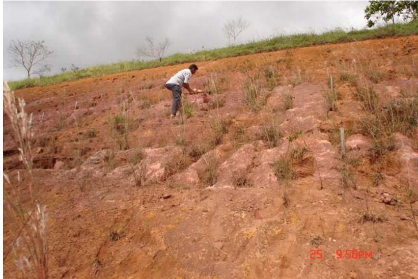
Figura 4 – Encosta decapiada para construção da praça de esportes do Departamento de Educação Física da UFV. Sem cobertura vegetal.
