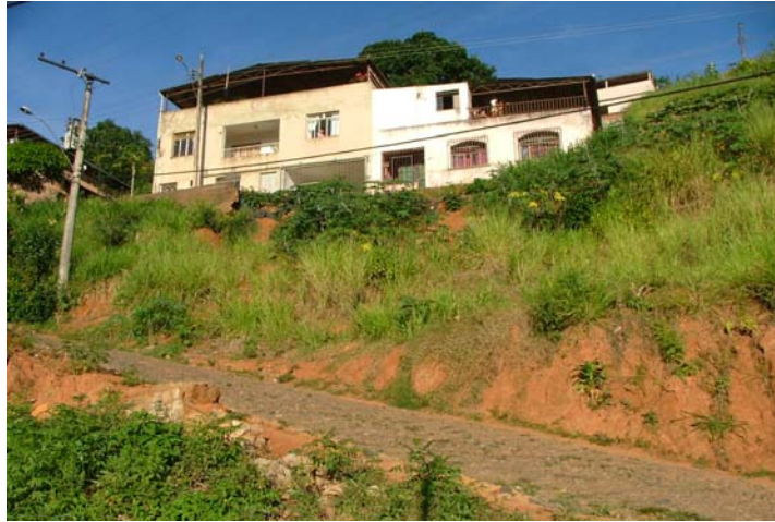
Figura 2 – Encosta Urbanizada – Bairro Centro – Esta área sofreu um escorregamento nas chuvas do ano de 2005, comprometendo a estrutura das casas acima e da rua que passava em frente a elas. Fonte: Os autores, 2005.
