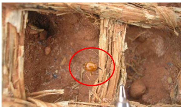
Figura 13 – Ação do cupim na biodegradação das geotêxteis. Autoria: BEZERRA, J.F.R, 04.12.05
