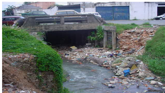
Figura 04: Exemplos de processos erosivos (1, 2 e 3) ao longo da microbacia Córrego Paciência – São Paulo/SP.
