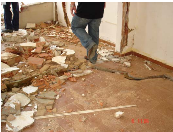
Figura 7 – Marcas dos movimentos de massa dentro de uma moradia.
