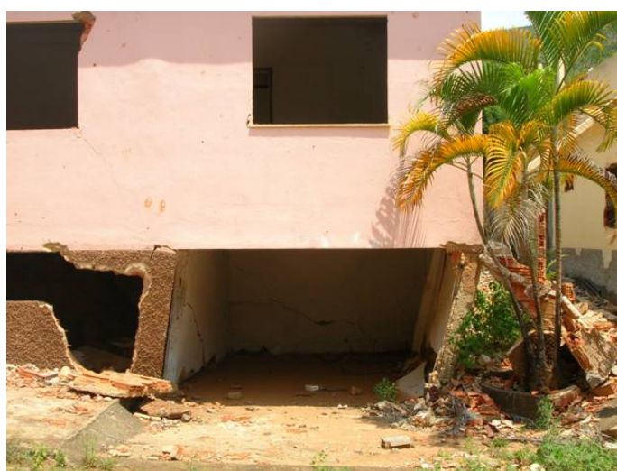
Figura 6 – Abalo em estrutura de edificação no Bairro Ninico.
