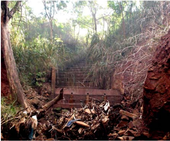
Figura 3: Dissipador na cabeceira da voçoroca e entulho na base. (F.C.M. Zaparoli, 2005)
