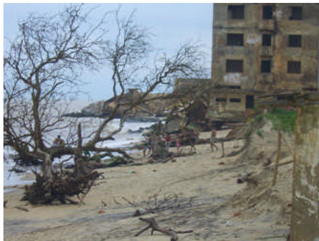
Fig. 2. Edificações severamente afetadas pela erosão nas proximidades do pontal de Atafona. Foto do autor principal registrada em fevereiro de 2008.
