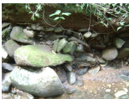
Figura 2: Matacões e blocos no talude marginal. Fonte: Arquivos dos autores.
