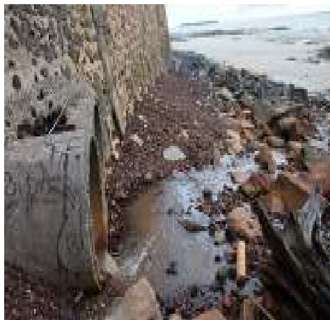
FOTO 02: Lançamento de esgoto “in natura” FONTE: Dados da Pesquisa
