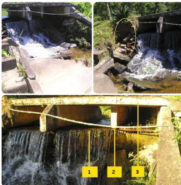
Fig. 2 - (A) Estado de deterioração do Vertedouro do “Lago 2”. (B) Estado de deterioração do Vertedouro do “Lago 2” - Observa-se à esquerda, processo erosivo remontante, ocasionado por turbilhonamento em momentos de fluxo d’água intenso, colocando em risco a via de acesso sobre a barragem do lago. (C) Estado de deterioração do Vertedouro do “Lago 2”. Os destaques apontam: 1. Base em concreto sobre material de aterro da barragem do “Lago 2”. Constata-se que, fruto do intenso processo erosivo remontante, o aterro que suporta o vertedouro já foi erodido em aproximadamente 1,5 metros em direção ao Lago; 2. O processo descrito resultou, também, na retirada de viga de sustentação da ponte de concreto em aproximadamente um metro de comprimento. Salienta-se que tal viga foi originalmente construída em blocos de cimento, material pouco apropriado para esse fim; e, 3. A ponte de concreto fixada sobre o vertedouro e as vigas perdeu parte de sua sustentação e, já em 04/02/2009, apresentava uma inclinação de aproximadamente 10°, rebaixada no sentido montante/jusante.
