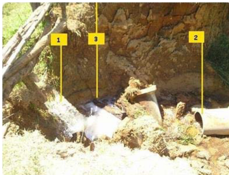
Fig. 3 - Estado de deterioração do Vertedouro do “Lago 3”, em 07/12/2008. Em 1 observa-se fluxo de saída do “Lago 3”, sem qualquer proteção, erodindo o solo abaixo da barragem. Em 2, tubulação sub-dimensionada, destinada à vazão de toda bacia de drenagem à montante. Em 3, aterro sob o leito carroçável da estrada, já totalmente suprimido pela erosão.
