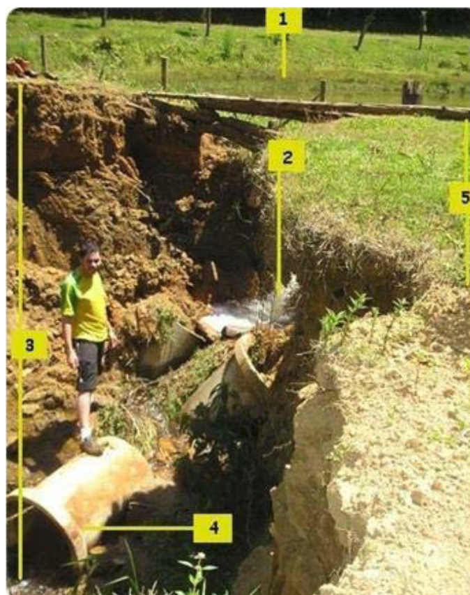
Fig. 4 - Estado de deterioração do Vertedouro do “Lago 3”. Em 1 observa-se porção do “Lago 3”. Em 2, o fluxo de saída do “Lago 3”, sem qualquer proteção, erodindo o solo abaixo da barragem. Em 3, aterro sob o leito carroçável da estrada, já totalmente suprimido pela erosão, com profundidade aproximada de 4 metros. Em 4, tubulação subdimensionada, destinada à vazão de toda bacia de
