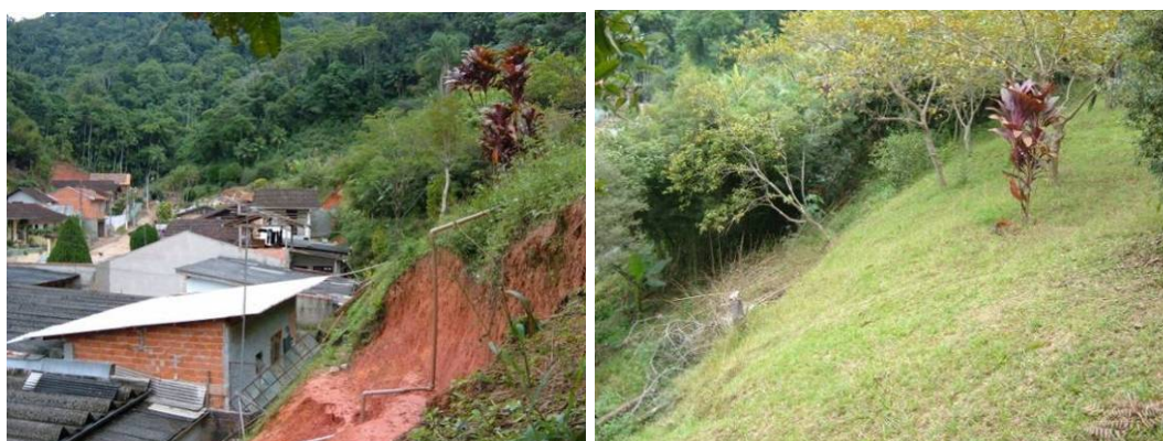
Figura 9 - Vista parcial da encosta norte desestabilizado (imagem da esquerda). Árvores inclinadas, mostrando um movimento de rastejo do terreno (imagem da direita). Fotos: Harideva M. Égas, junho de 2009.
