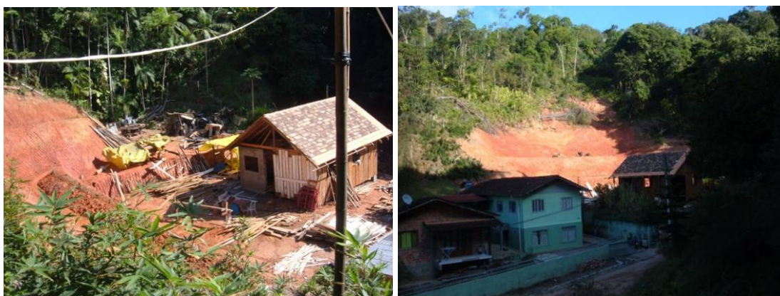
Figura 7 - Residência sendo reconstruída em mesma área onde ocorreu um escorregamento que a destruiu totalmente. Fotos: Harideva M. Égas, junho de 2009.
