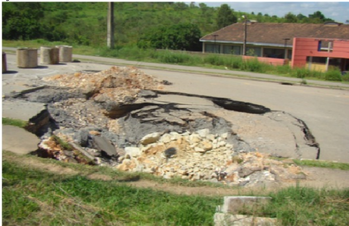
Instabilidade geológica com presença de várias dolinas em via urbana do município de Almirante Tamandaré – PR Foto: Martins A. (01/2011)
