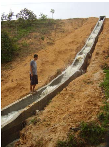
Figura 5 – Sem a construção desta canaleta, a grande quantidade de água por ela escoada propiciaria a rápida expansão da incisão. (VIEIRA, 2006).
