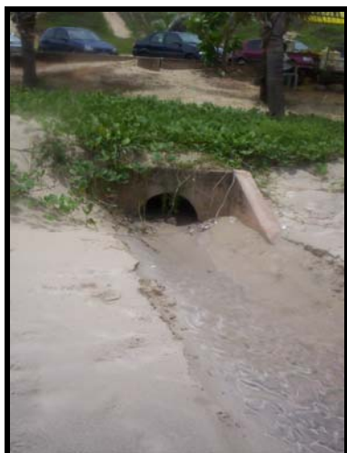
Figura 07: esgoto (arquivo do autor)
