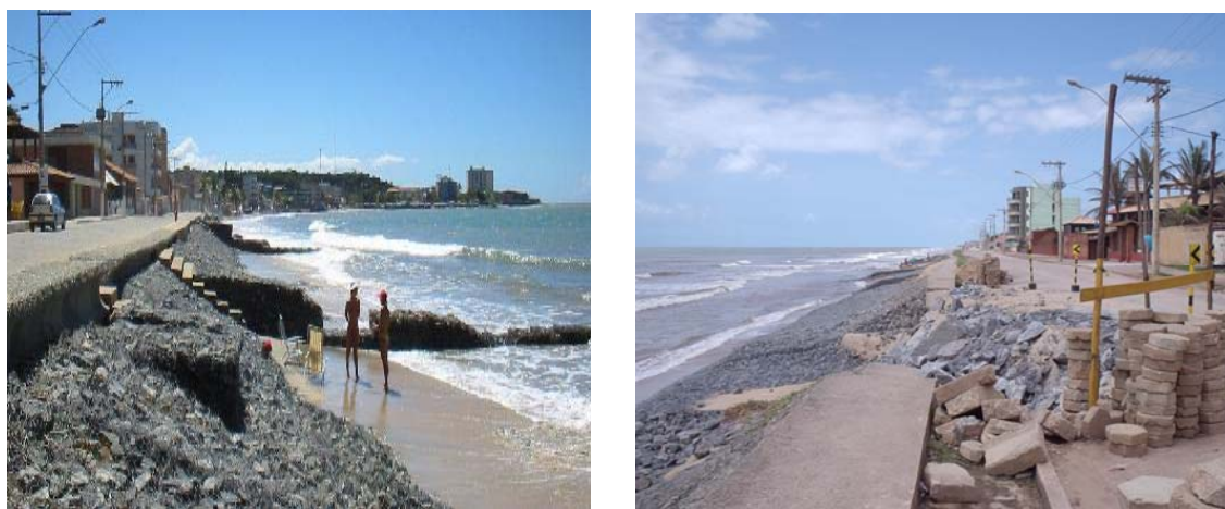
Figura 2: (a) Obras realizadas em 2000 e (b) Setembro de 2005, contenção não impede o recuo da costa na praia central de Marataízes, ES.
