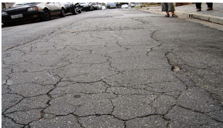
Figura 4: Ponto 9. Asfalto deteriorado, com trincas, devido a intensidade do escoamento superficial. Eduardo T. Nakamura, Fev/2006.
