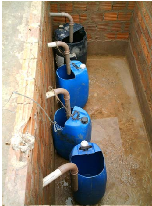
Figura 4 – Tanque com galões coletores de água e sedimentos
