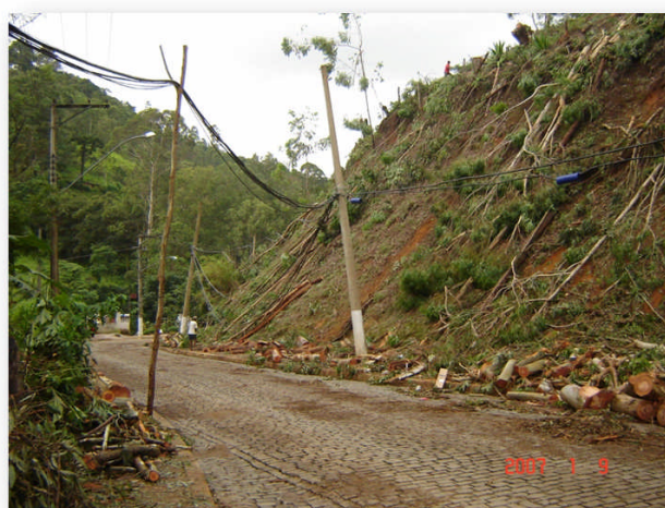
Foto 02: Deslizamento de encosta no bairro de São Geraldo, em janeiro de 2007 (Foto: da autora)
