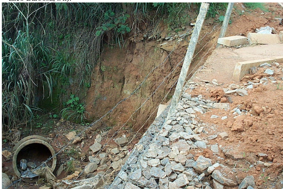
Fig. 10: Equipamento urbano para recepção e vazão do escoamento pluvial de arruamento. É importante observar que um antigo sistema construído com tubulação e aterramento foi destruído pela erosão pluvial, o que tornou necessária a instalação de novo equipamento baseado na utilização de gabiões. (Fotografia obtida em 02/04/2008, na Rua Zico Barbosa, s/n).
