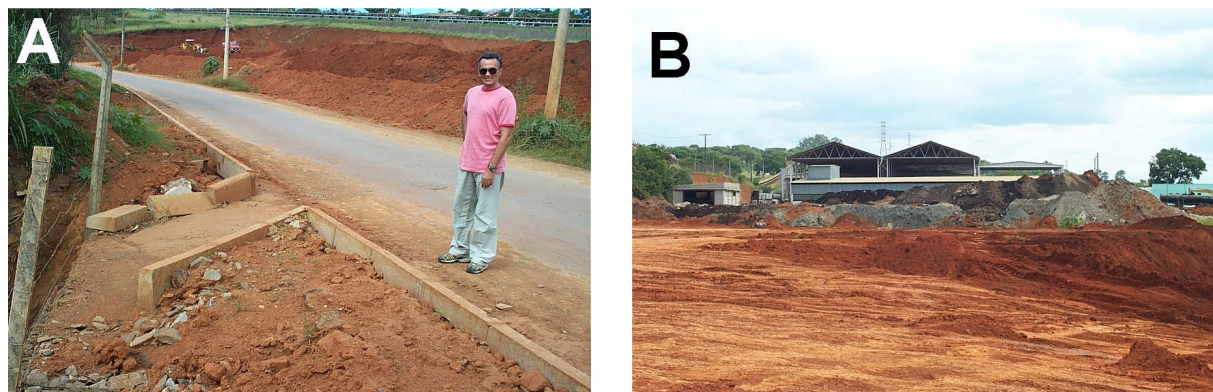
Fig. 09: Produção de sedimentos na área do Distrito Industrial pela ação antrópica. A : Corte de talude para desaterro; B : Disposição de pilhas de estéreis a céu aberto. (Fotografias obtidas em 02/04/2008, em corte de desaterro e instalação industrial localizados à Rua Zico Barbosa, s/n).
