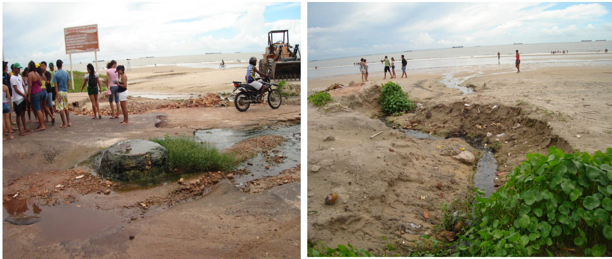
Figura 03 e 04: Esgoto sem tratamento com contato direto a praia
