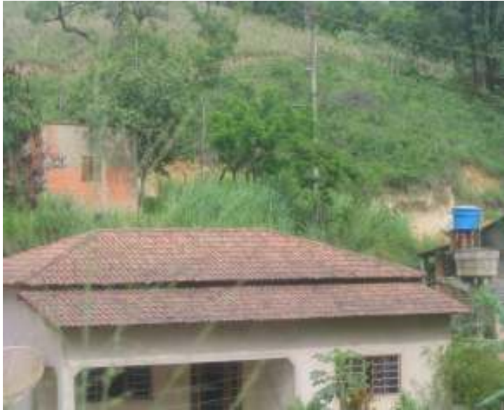
Figura 06 – Situações das residências na bacia da contagem. Processo erosivo atuante.
