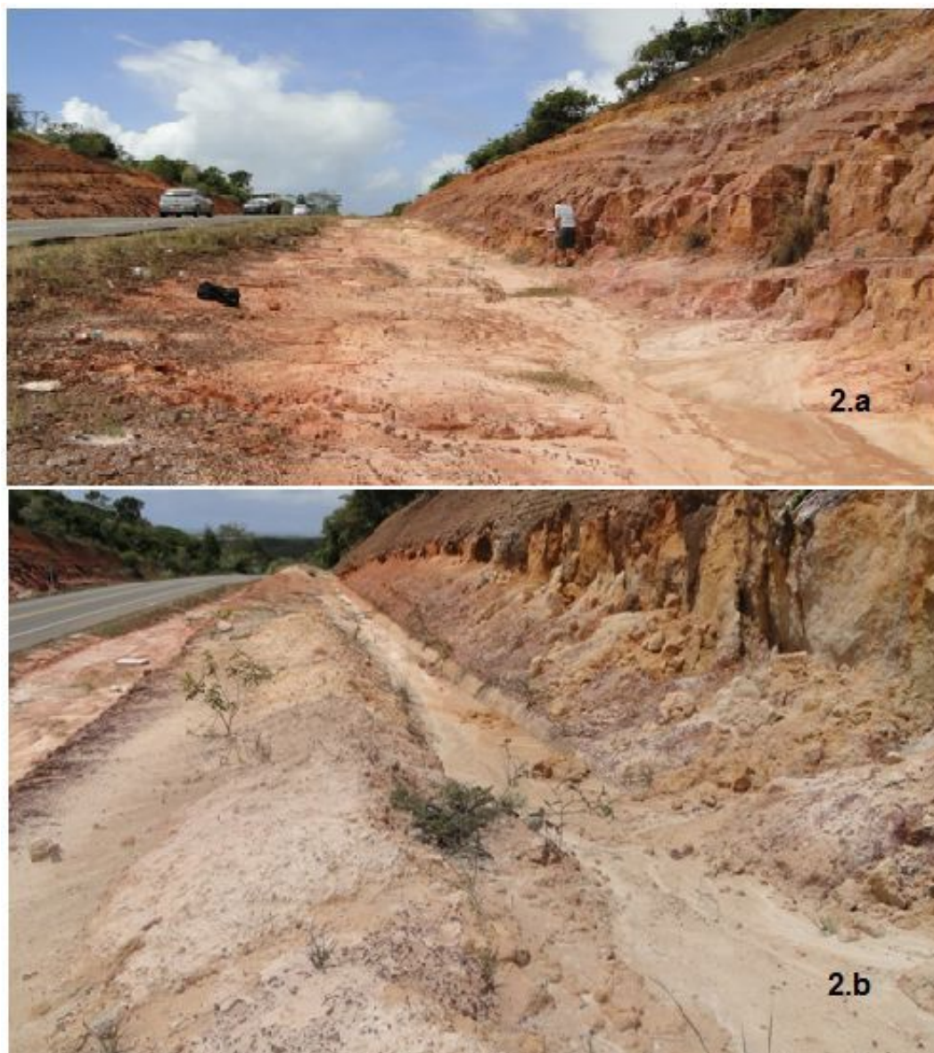
a - Vista do afloramento B (24L 0613810; UTM 88622638). b - Canaleta proveniente da contenção tipo: Berma/canaleta.
