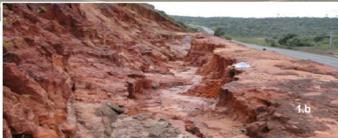
a - Foto panorâmica do afloramento A. b - Local onde se encontrava a canaleta da contenção aplicada.
