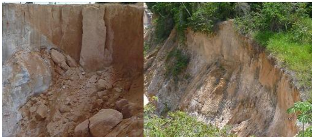
Cicatrices de ovimento de massa, na primeira pode ser observado uma caicatriz de uma queda em bloco e na segunda uma de escorregamento translacional
